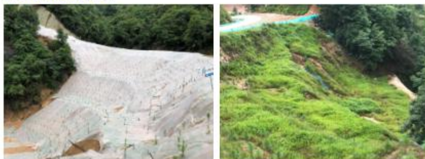
图 3-1 2#弃土场表面现场照
